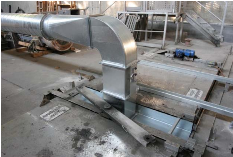
Abbildung 5: Ansaugstutzen des Filterprüfstandes
