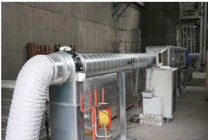
Abbildung 2: Filterprüfstand am Plabutschunnel
